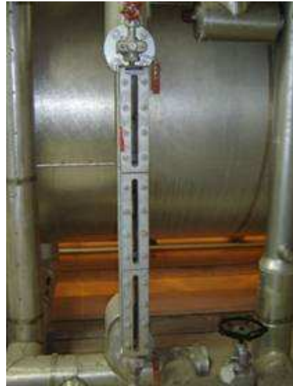
ภาพที่ 2 ตัวอย่าง sight glass ที่ใช้ติดตั้งบริเวณถังเก็บสาร Acetic anhydride
